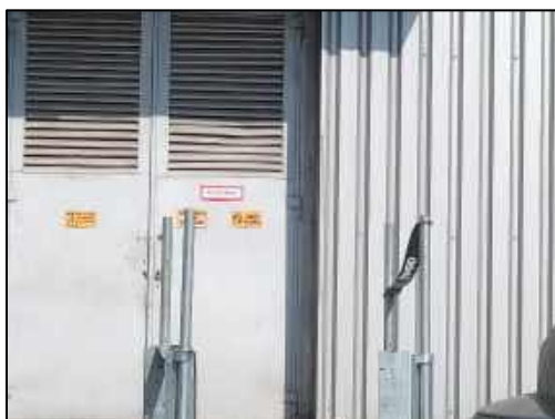
Budynek niemieszkalny (trafostacja) nr ewidencyjny 1341
